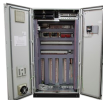
Системы противоаварийной защиты (СПАЗ)
